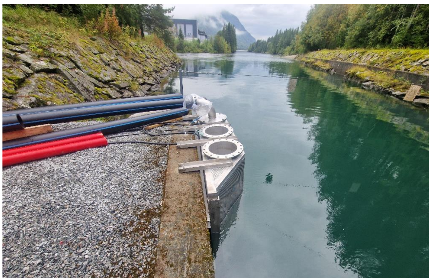
Figur 9. Det er etablert løsning med sil/gitter-kasse fastet i betongkonstruksjon til kanal.
