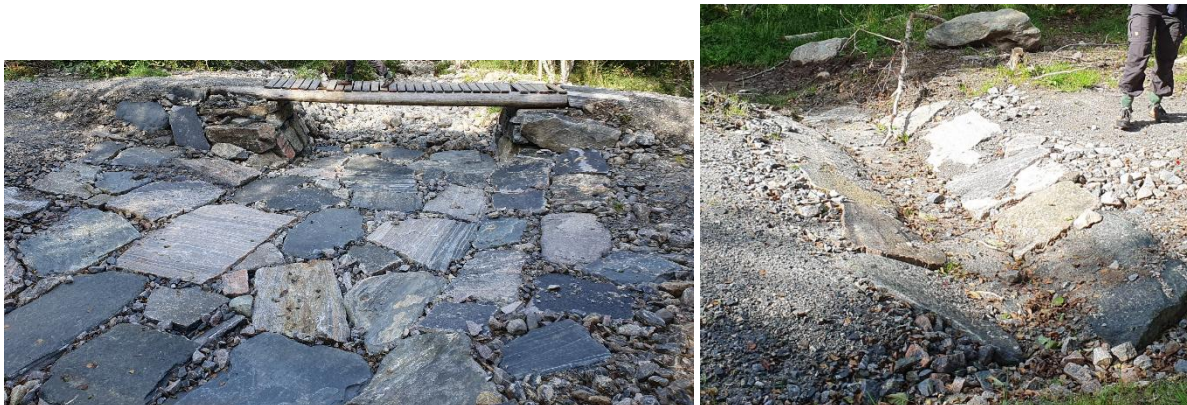
Figur 9: Senket og steinsatte lavbrekk over veg. Foto: Ingvild Brekke, Skred AS
