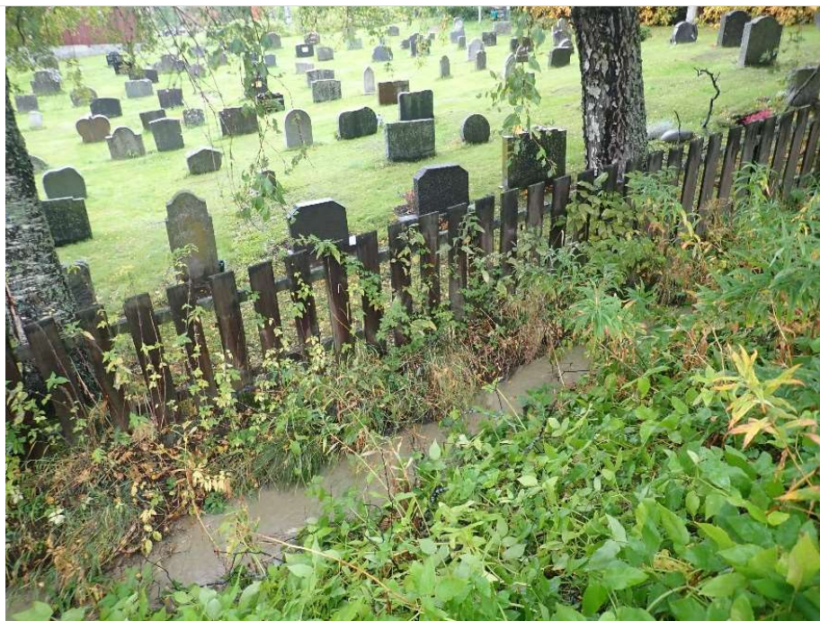
n-7: Bekken renn i lausmassar tett på gravplass. Liten høgdeskilnad mellom bekkeløp og terreng. Naturleg steinsatt (delvis), enkelte teikn på erosjon. Fare for erosjon mot gravplassen ved kraftige byger. anbefaler å vurdere erosjon- og flaumsikring mot gravplass.
