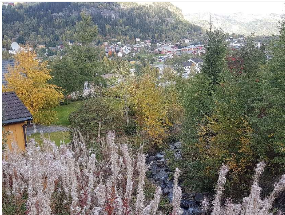
n-8: Yttersving mot Strandalivegen 22, ikkje plastra, kanskje eldre steinmur på deler av strekket. Erosjonsfare. Anbefaler å kartlegge sikringsbehov.
