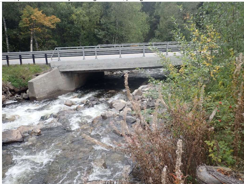
t-8: Bru under Rv7. Uviss lysopning. Noko synleg erosjon ved austre brukar. anbefaler erosjonssikring av brukarene.
