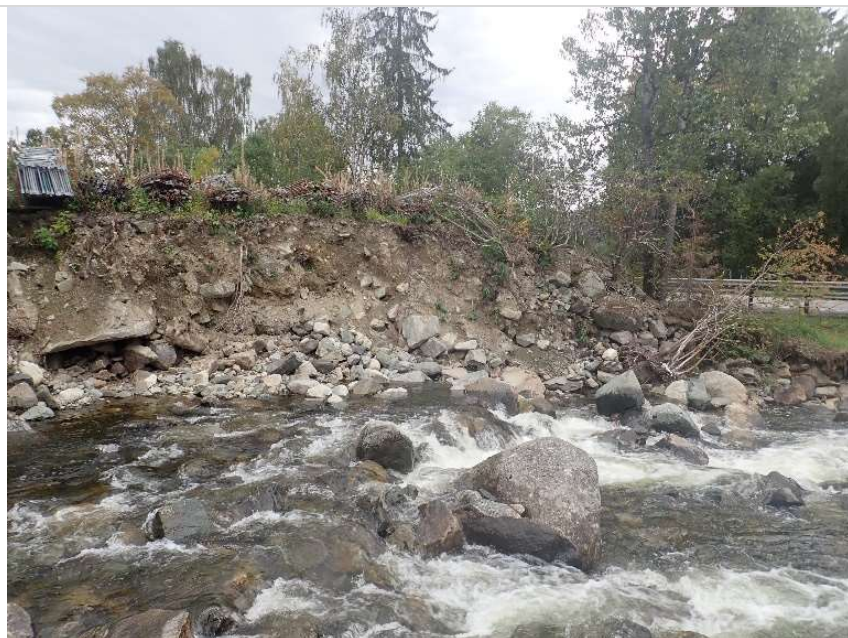
n-6: Synleg og kraftig erosjon i yttersving av elva like før brua under Rv7. Kollaps av bru/veg ved massiv erosjon. Vatn i veg ved tilstopping, men vil også renner over vegen og ned att i elveløpet. anbefaler erosjonssikring av bekkeløpet og sidene.
