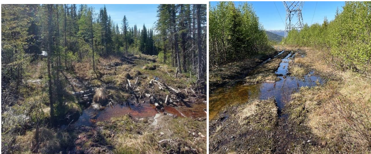
Figur 11: Eksempel på lavbrekk over traktorvei/kjørespor til venstre og eksempel på manglende lavbrekk der vannet følger kjøresporene istedenfor bekkeløp til høyre. Foto: Skred AS
