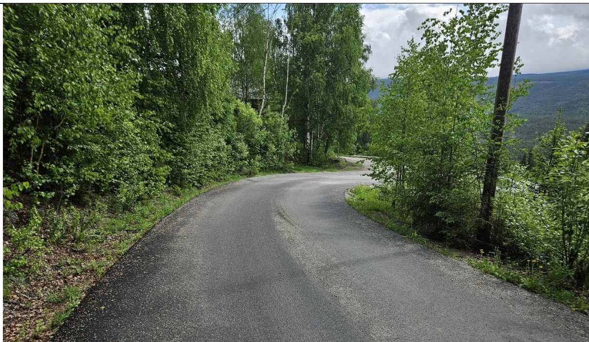
Bilde av veggrøfta oppstrøms 2A som vi anbefaler at utbedres. Bøygardsvegen svinger mot høyre i bakgrunnen av bildet, mens Skjervheimvegen går ut til venstre i bakgrunnen.
