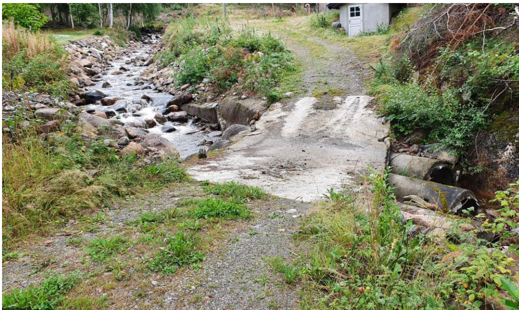
Figur 12: Eksempel på flombru i betong med stikkrenner og lavbrekk. Merk at utformingen i dette eksempelet ikke er optimal. Foto: Petter Reinemo, Skred AS
