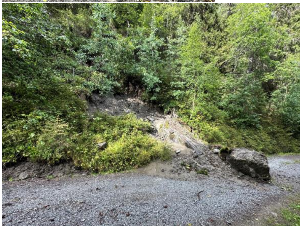
Figur 13: Detaljbilder av erosjon langs Klyvsetvegen og utglidning ned i Klyvsetvegen like over løснеområde for skred mot Klyvsetvegen 9 og 15 (Figur 14).
